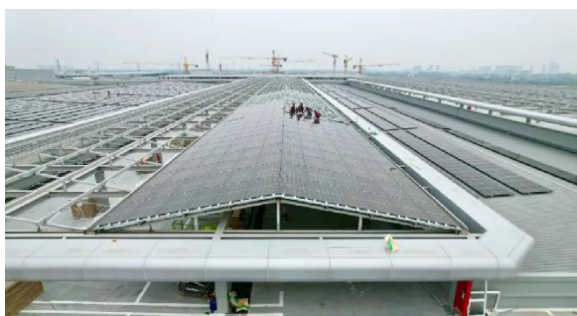
浙江振石股份新能源产业园，6兆瓦分布式光伏 屋顶系统
