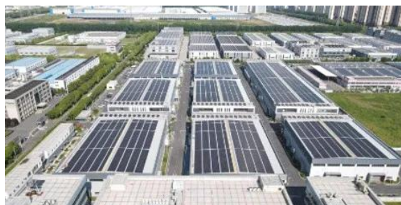
江苏常州新北区碳纤维产业园，18兆瓦分布式光伏屋顶系统
